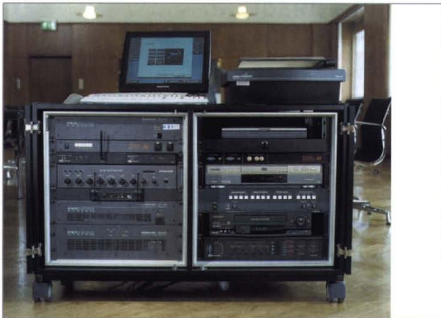
Fahrbarer Medienschränk bei DeTeCard. Sämtliche Anschlüsse für Medientechnik und Raumfunktionen (bis auf Stromversorgung) liegen auf einem einzigen Spezialstecker.
